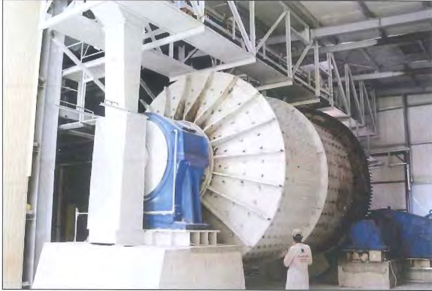
Şekil 3. Niğde kalsit işletmeleri öğütme tesisinden bir görünüş
